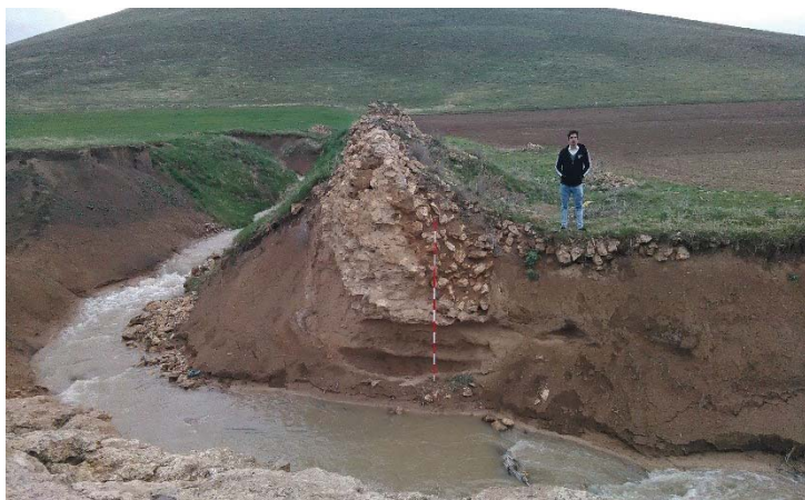
محل تخریب سد و سرریز آب
