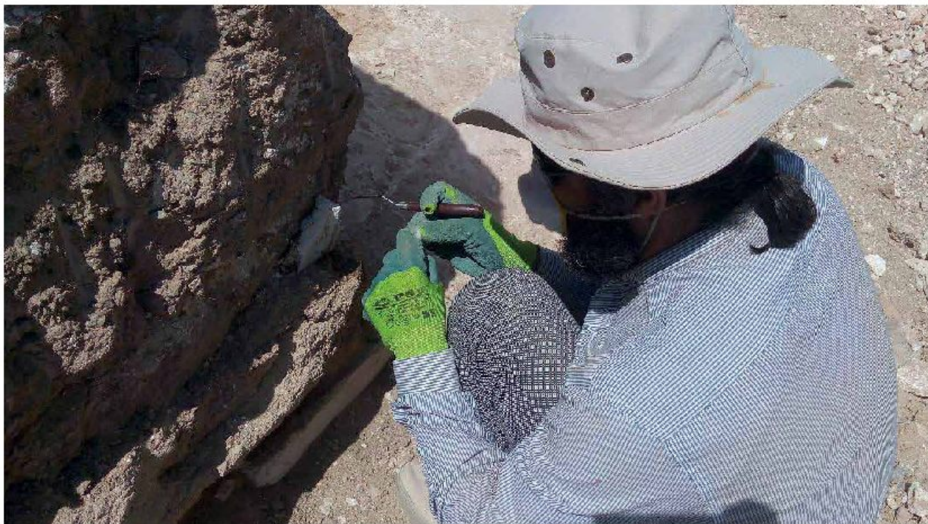
▲ تصویر ۲. عملیات تثبیت بخش‌های باقی مانده از لندود گچی دیوارهای خشتی Fig 2. Solidifying operations on the fragments of stucco remained on the walls made by mudbrick
