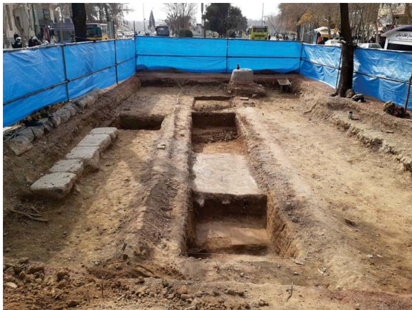
تصویر ۱۰. تخریب کامل کف‌سازی‌های تاریخی و حفظ ۵ سنگ تراش‌خورده لبه خیابان در کارگاه ۲
