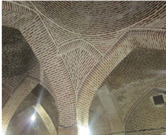
تصویر ۳۱. تزئینات آجرکاری جناغی زیر گنبد‌های ناو میانی شبستان مسجد جامع مهاباد
