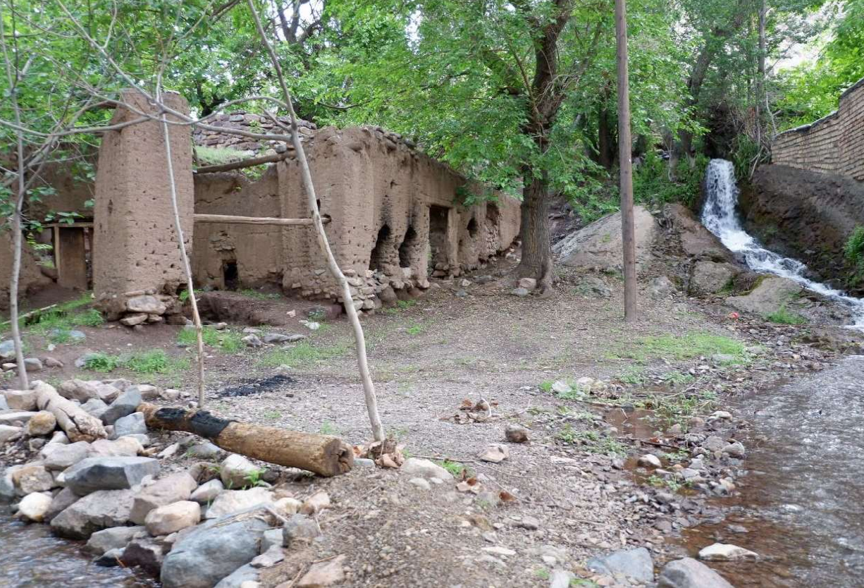
شکل ۲۴. فروریختگی در پوشش دالان جنوبی و دیوار امنیتی کاروانسرا
